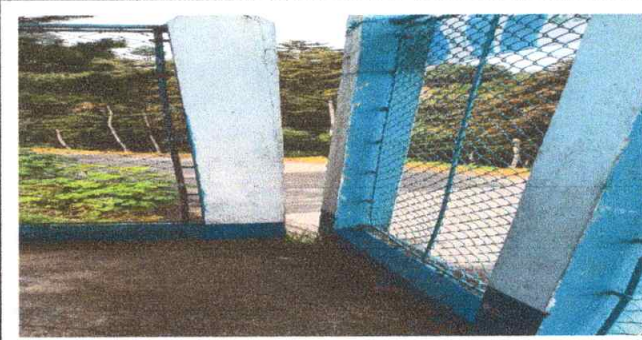
Foto 4: Grieta en el muro de contención
